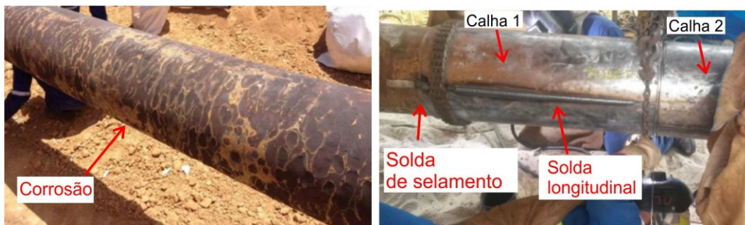
Figura 4. Reparo em operação de oleoduto da Petrobras que sofreu corrosão. Em a) Tubo com corrosão alveolar; b) Duplas-calhas tipo B emendadas para reparo permanente do duto. Adaptado de Oliveira [4].
